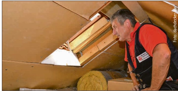
Leider allzu oft noch traurige Realität unter deutschen Dächern – die weitgehend wirkungslose „Do-it-Yourself“-Wärmedämmung, die der Schimmelbildung Vorschub leistet.
